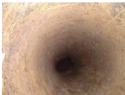
Conduit après ramonage
