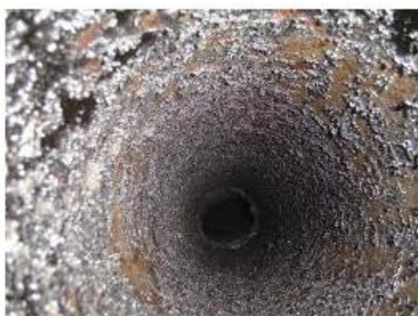
Conduit avant ramonage
