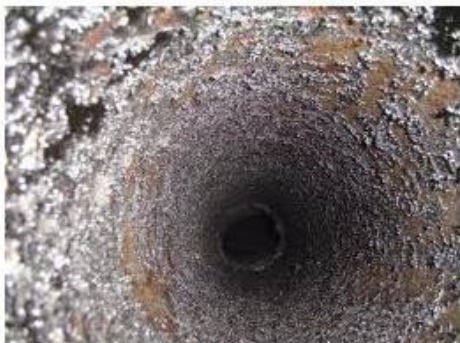
Conduit avant ramonage
