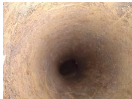
Conduit après ramonage
