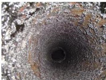
Conduit avant ramonage
