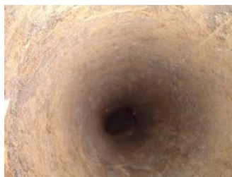
Conduit après ramonage
