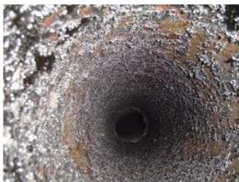
Conduit avant ramonage
