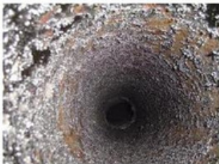
Conduit avant ramonage
