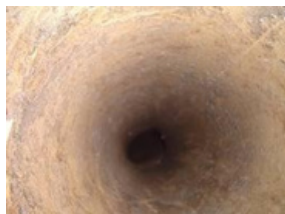
Conduit après ramonage
